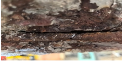
(b) 锈蚀钢筋断裂
