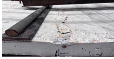
(a) 板顶混凝土压碎
