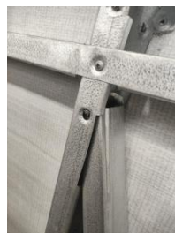
(a) 受压侧下部斜撑与立柱连接处螺钉失效
