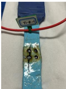
图5 防腐层起泡、开裂、剥离形态
